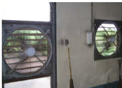
換気扇 手が届くため稼働中に触ろうとした
