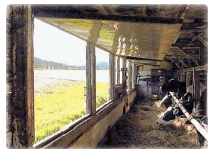
はね上げ窓にした事例（凍結しづらく、開閉しやすい）
