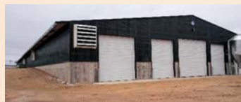
外壁を紫外線99%カットのVESのポリカに交換した育成舎外観
