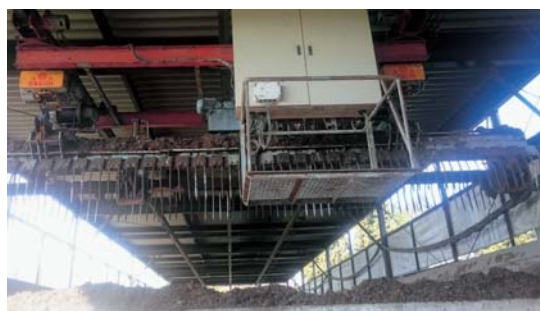
幅7mの堆肥クレーン
